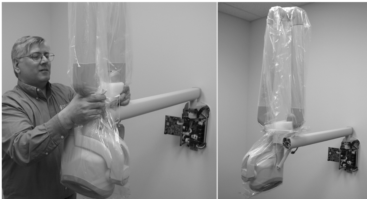
Figure 20 Installation du bras articulé et de la gaine de tube radiogène
